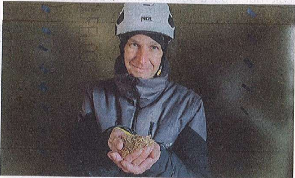
Frédéric Cousin, assistant technique à maîtrise d'ouvrage, explique le procédé de l'insufflation de la paille hachée.
